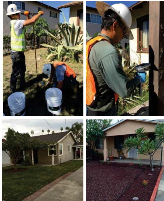
Fotos: Análisis de la tierra, análisis de la pintura, y reemplazo de tierra limpia y restauración de la jardinería.
